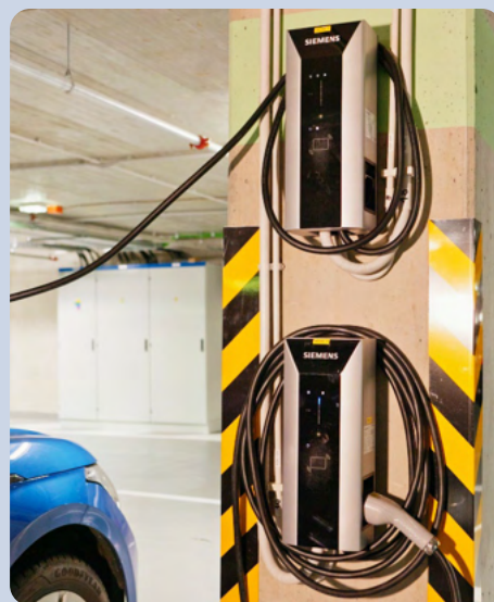
Nabíjačka pre elektromobily Siemens VersiCharge
